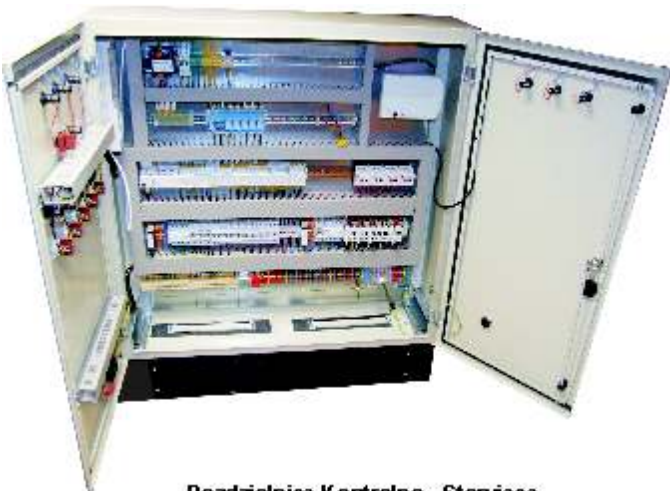
Rozdzielnica Kontrolno - Sterująca na bazie szafy RSB wykonana w/g projektu klienta
